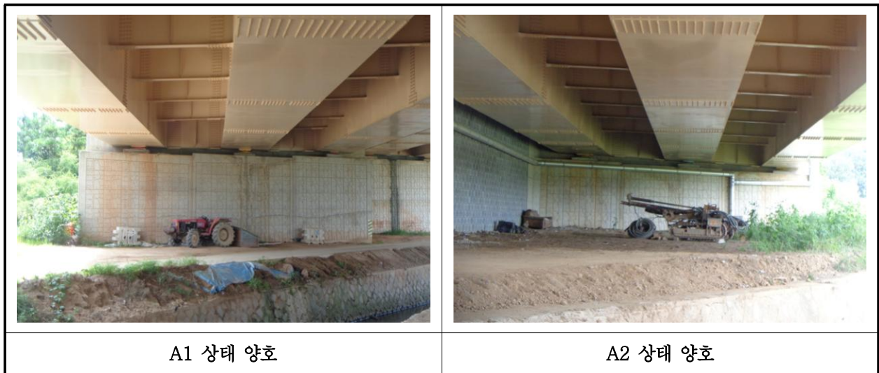
【사진 13.3.30】 교대 손상현황
